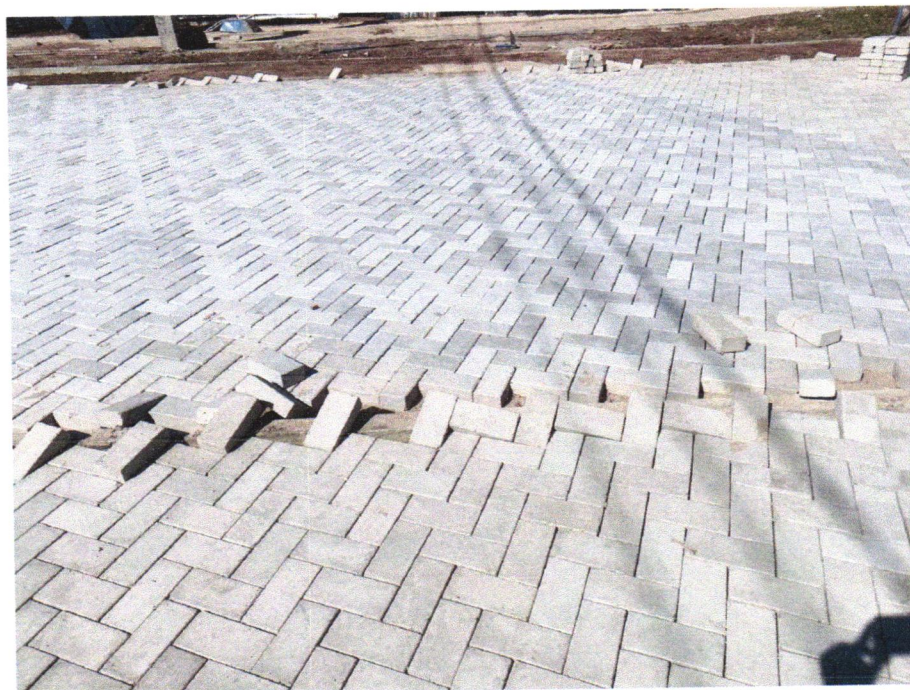
Foto 08 - EXECUÇÃO DE PASSEIO EM PISO INTERTRAVADO, COM BLOCO RETANGULAR COM ACABAMENTO NATURAL DE 20 X 10 CM, ESPESSURA 6 CM. AF_12/2015
